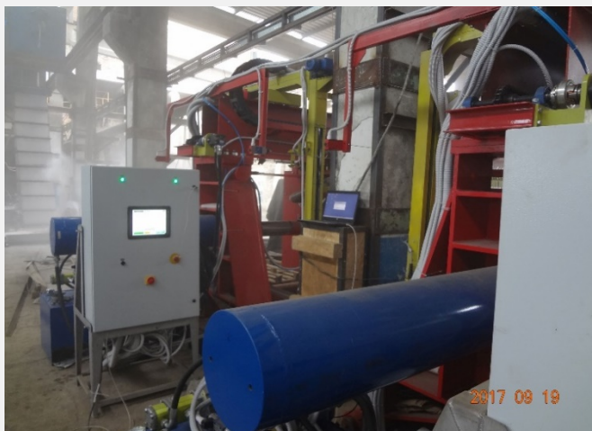
Рис. 3 Шкаф управления фильтр-пресса
